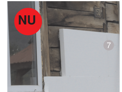
AȘA NU: placiul cu polistiren la exteriorul pereților din bârne de lemn este dăunător, lemnul nu respiră, durata de viață a construcției este diminuată iar calitatea spațiilor interioare specifice caselor din lemn este anulată.
