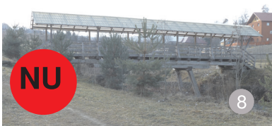
8 AȘA NU: podul este construit corect, din lemn, dar pentru acoperiș s-au folosit plăci ondulate transparente din material poliester.
