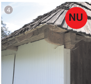
AȘA NU: lambriu din plastic aplicat peste pereții din bârne din lemn. Această soluție scade durata de viață a bânelor din lemn pentru că materialul nu mai respiră iar în spațiul dintre lambriu și perete se produce condens; prezența apei duce la putrezirea lemnului;
