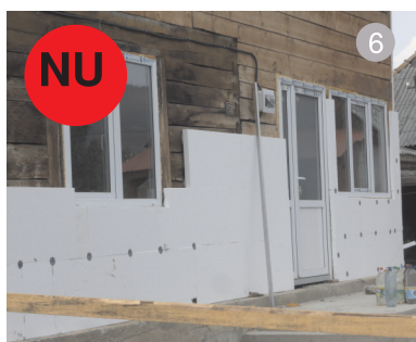
AȘA NU: se interzice aplicarea plăcilor de polistiren pe pereții din bârne din lemn; materialul nu va mai respira astfel că într-un timp foarte scurt bârnele din lemn se vor degrada;
