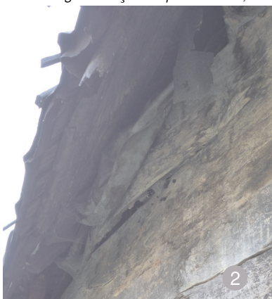
degradarea bânelor superioare din cauza infiltrațiilor de apă prin acoperiș;
