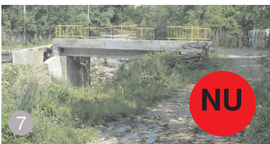
7 AȘA NU: pod beton.
