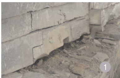
talpa casei a fost înlocuită în zona în care soclul a cedat; se observă semne de degradare și la talpa înlocuită;
