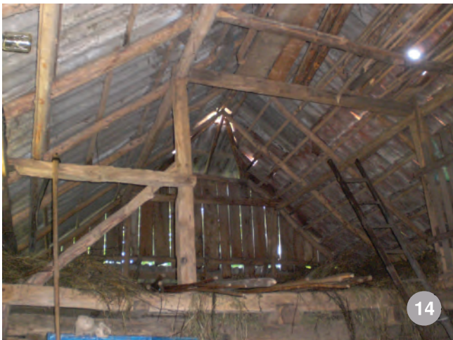
șarpantă de șură cu timpan teșit- vedere spre timpan. Se observă ingeniozitatea cu care se obține deschiderea mare necesară manipulării fânului
