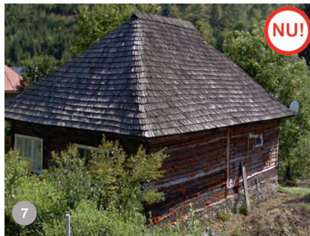
A A NU- spumă poliuretanică injectată între bărnele de lemn ale unei case- Strâmbu Băiuț
