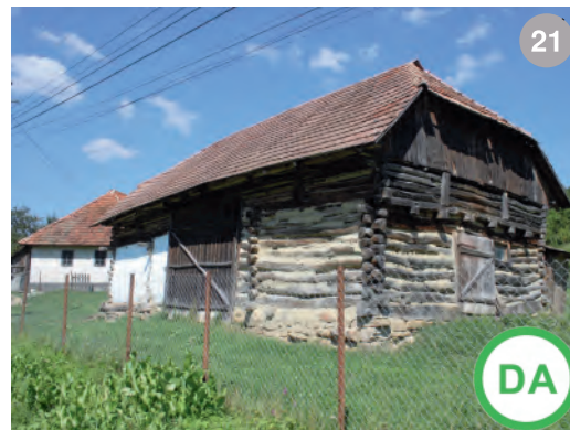
A A DA: Chiuești- acoperiș din țigle ceramice- coloritul țiglelor vechi se încadrează bine în cadrul construit
