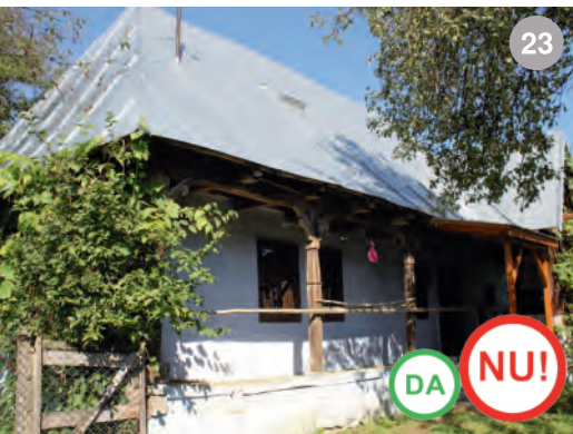
Casă în Măgoaja- deși a fost păstrată forma acoperișului- A A DA!- șindrița a fost înlocuită cu tablă care contrastează cu materialele tradiționale- A A NU!
