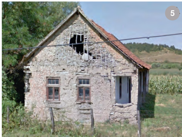
5 casă în Racova. Din cauza degradării casei, se observă structura pereților și timpanul din împletitură de nuiele
