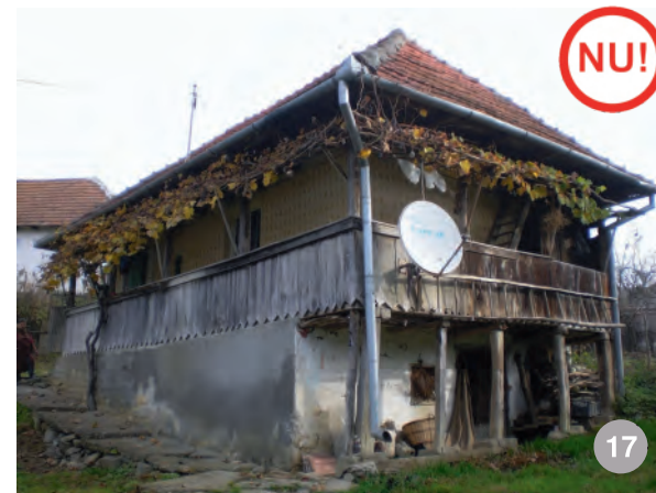
AȘA NU: Ulciug- trotuar din beton pe lângă soclu- se vede că acesta este afectat de umezeală. Se recomandă soluții de trotuar care nu sigilează solul și tencuieli ecologice pentru soclu.
