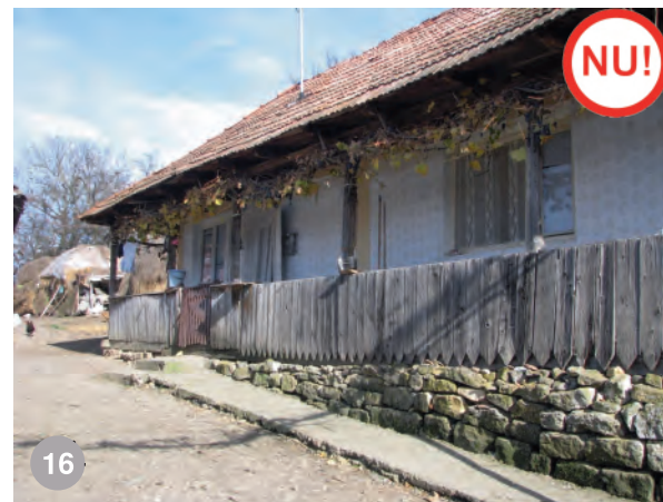
AȘA NU- trotuar din beton la Ulciug- se observă soclul afectat de umezeală. Se recomandă soluții de trotuar care nu sigilează solul.
