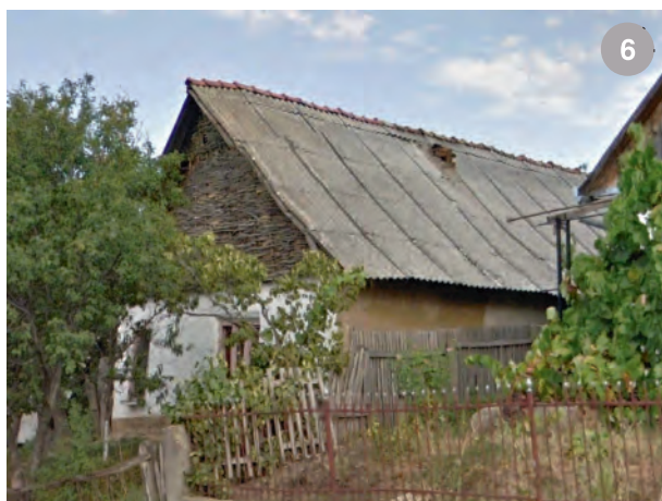
6 casă în Giorocuta- este vizibil timpanul din împletitură de nuiele de pe care a căzut tencuiala
