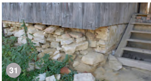
Magazie la Nadiș. Se observă cum sprijinul unui colț s-a surpat
