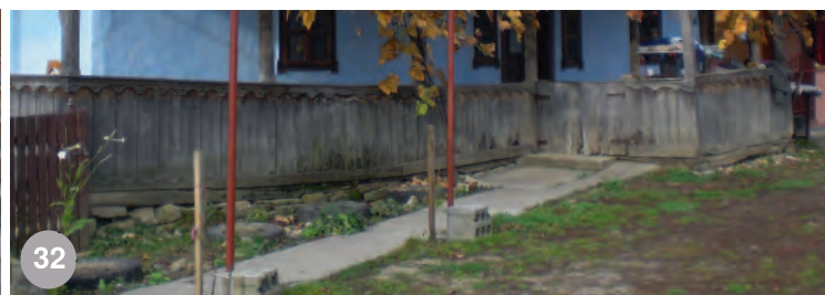
Casă în Ulciug- se observă dezavantajul sistemului "pe boci": talpa târnațului e flambată, nefiind susținută în zona mediană
