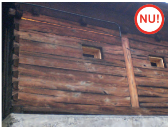
șură reabilitată greșit cu injectare de spumă poliuretanică între bârnele de lemn- AȘA NU!
