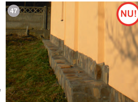
AȘA NU!- soclu și trotuar placate "rustic"
