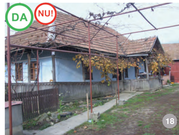
Ulciug- trotuarul este realizat din beton- AȘA NU!- dar este depărtat de soclu- AȘA DA!
