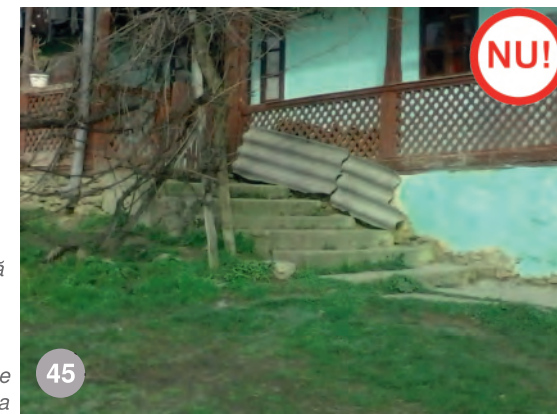
AȘA NU!- trepte din beton la Odești
