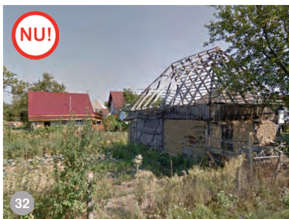
AȘA NU: acoperiș din țigle de tablă la Sălsig- culoarea tare și strălucirea afectează armonia cadrului natural și construit
